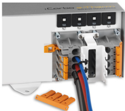
Abbildung 4: Zugentlastung mit Kabelbindern
